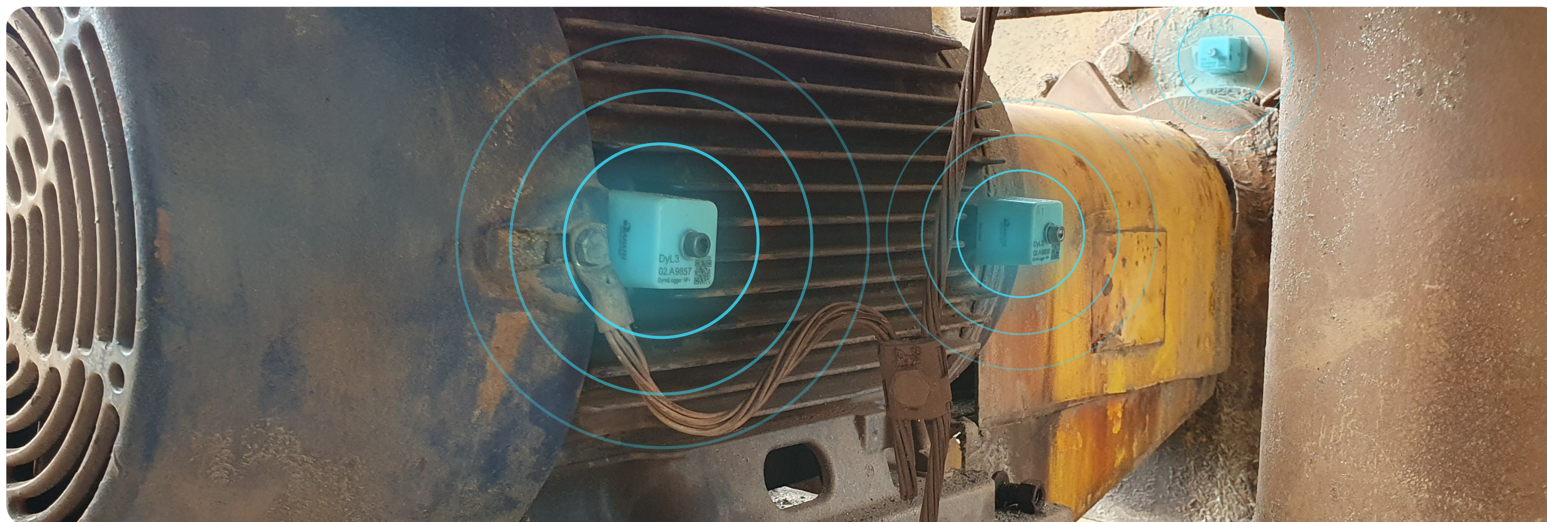
Motor e mancais de excitadores
